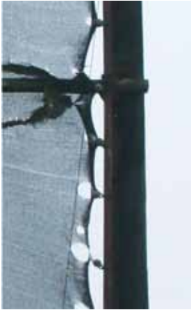
Foto 3.9: La presión del viento puede generar una concentración de tensiones en las zonas de fijación, iniciando la ruptura de la malla (Proyecto Atrapanieblas).
